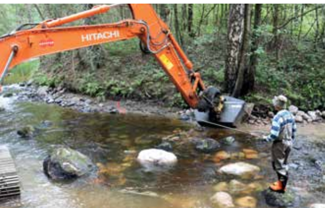
Virtavesien hoitoyhdistys Virho ry:n Markus Penttinen toimi rapellimestarina kun Karkkilan Majalankoskea kunnostettiin koneellisesti kesällä 2019. Kunnostus oli myös osa Länsi-Uudenmaan vesi ja ympäristö ry:n Freshabit LIFE IP -hanketta ja sitä olivat rahoittamassa myös SLL:n EKOenergia rahasto, muusirkko Samuli Spekti Huhtala, kalastusosakunta sekä Karkkilan kaupunki. Kuva Juha-Pekka Vähä LUVY.
